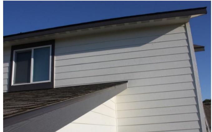
Techo del patio (en la parte inferior izquierda de la foto) donde el instalador estaba parado, haciendo palanca sobre el techo superior cuando cayó.
